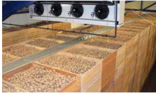
Der höhere Energiebedarf beim Einsatz maschineller Kälteanlagen in der Kartoffellaagerung lässt sich durch mechanische und steuerungstechnische Lösungen reduzieren. (Foto: Versuchsstation Dethlingen)
