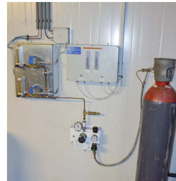
Lagerversuche unter Ethylenatmosphäre: Hier wird Ethylen in Druckgasflaschen angeliefert und mit Hilfe einer Steuerungseinheit in den Lagerraum eindosiert.
